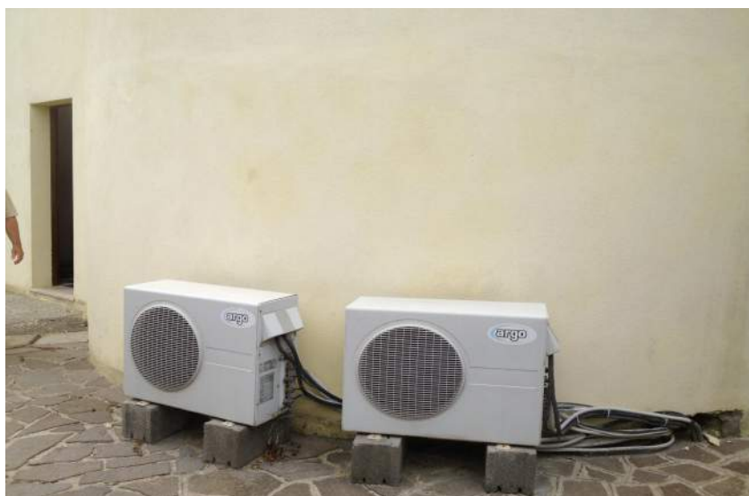
Fig. 14 (sopra e sotto): unità esterne per la climatizzazione dei locali
