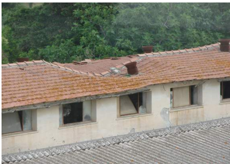
Fig. 43: Allevamento cunicolo (vista dall'alto della struttura di copertura pericolante)
