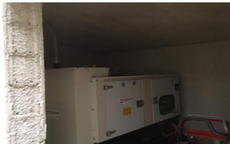
Fig. 49: Gruppo di continuità, interno
