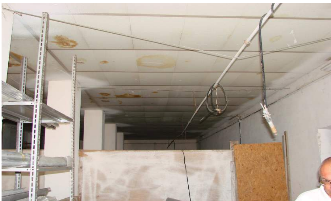
Fig. 33: controsoffittatura ammalorata magazzino (locale appoggio a ovest)
